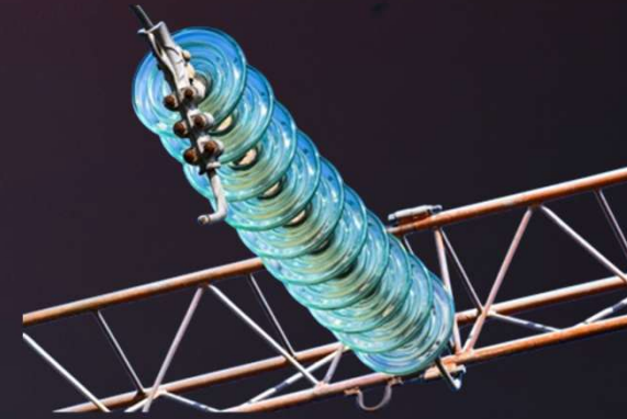
Isolador de Vidro 138kV
