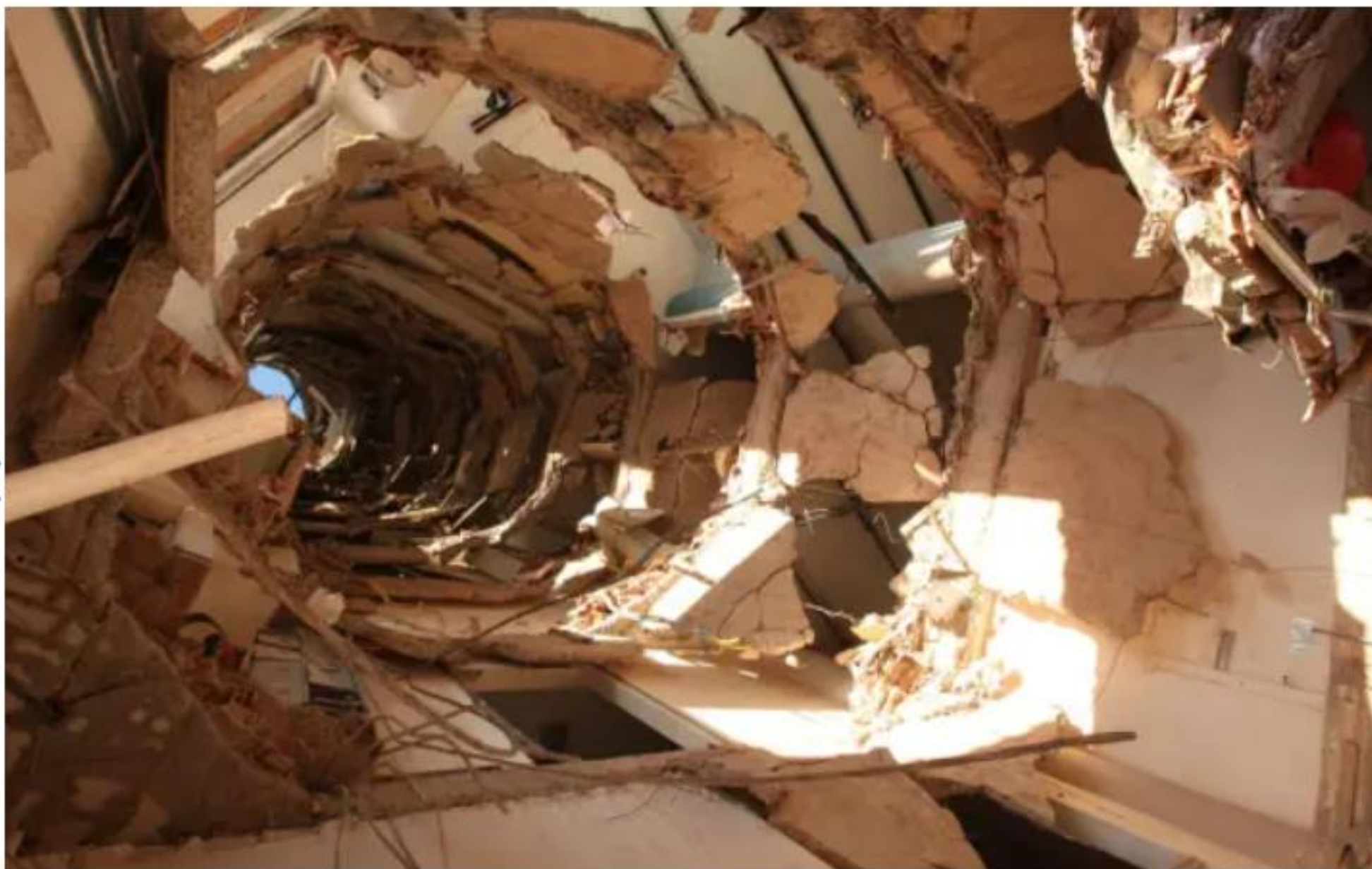
1/7 Desabamento de laje de prédio em São Bernardo do Campo (Tiago Queiroz/AE/VEJA)
