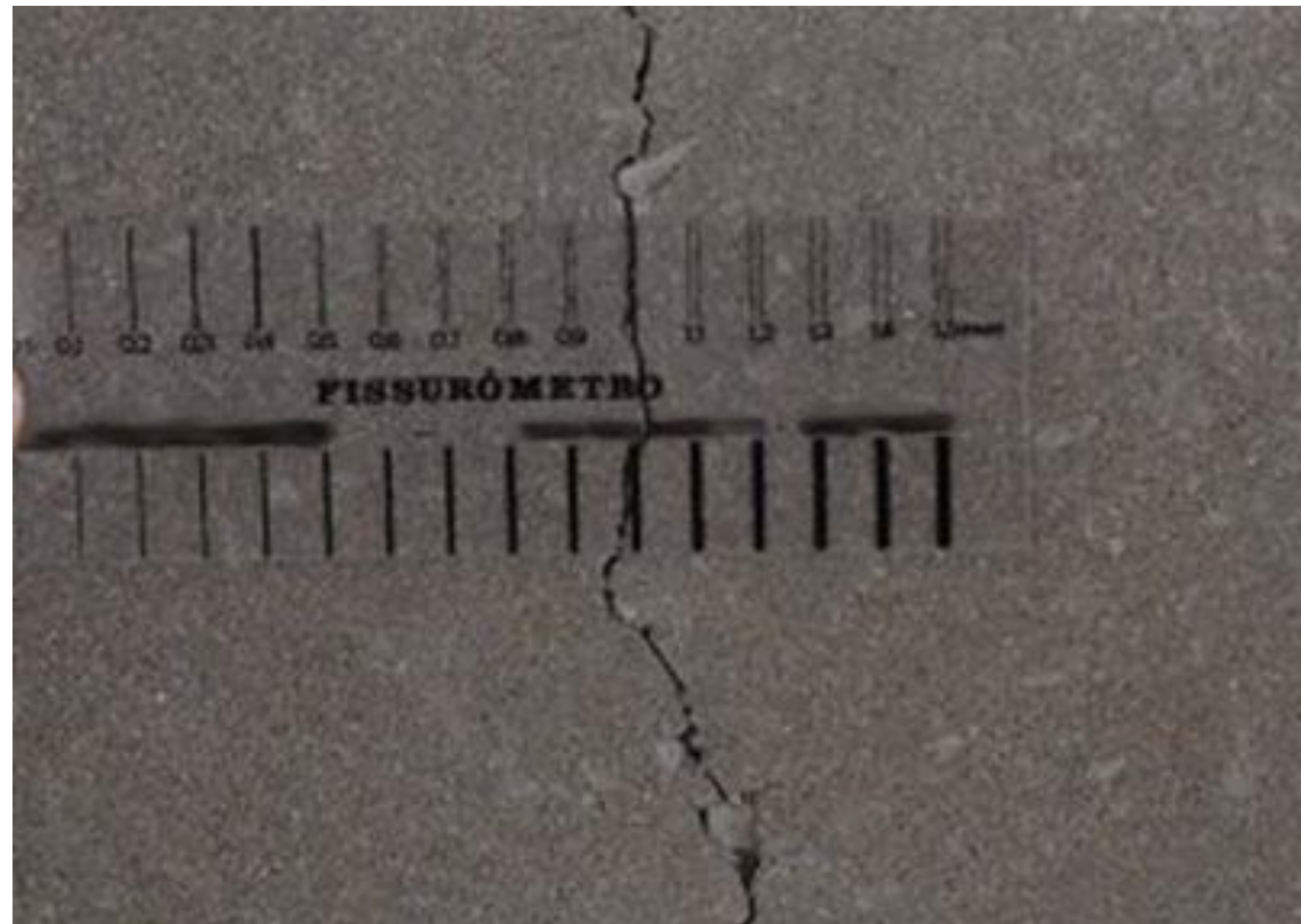
Penetração da água por fissuras
