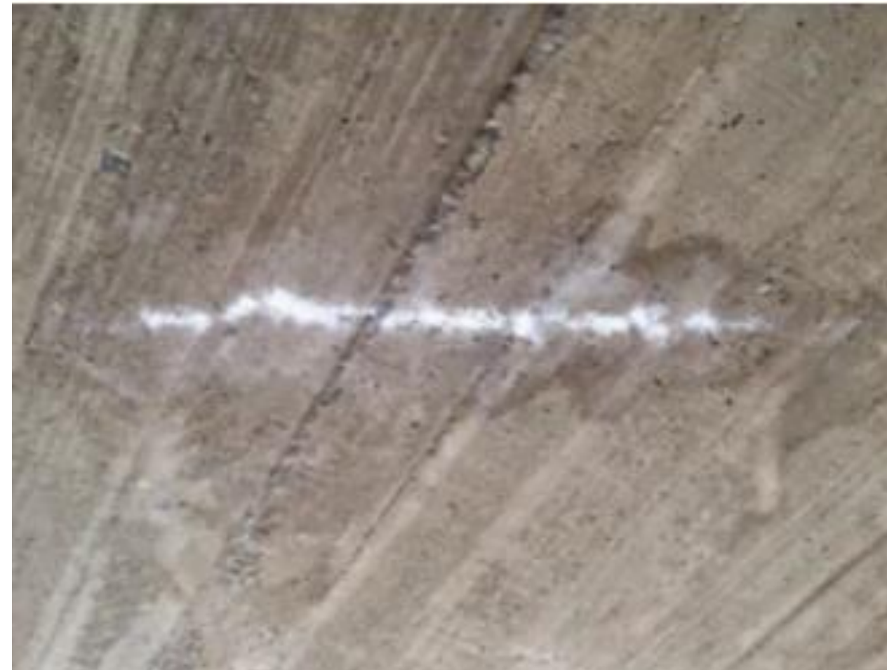
Penetração da água pela porosidade do concreto
